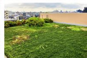
▲屋上や校庭の緑化で日射熱を緩和
