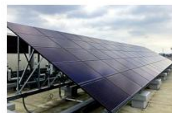
▲災害の停電時にも電力供給が可能
